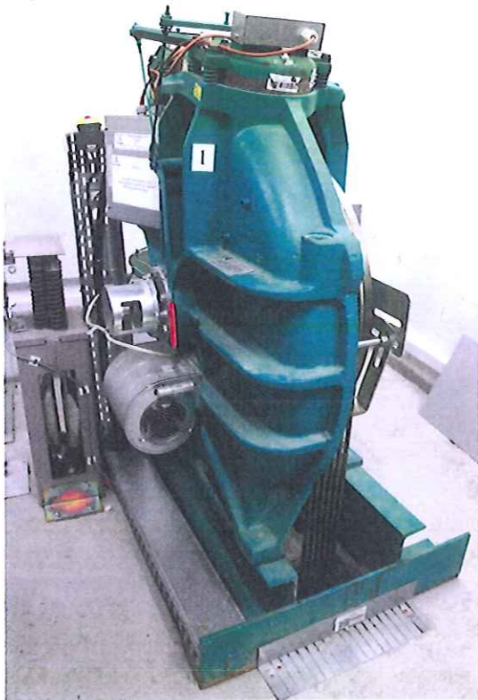
Fot. 1 Wciągarka bezreduktorowa w górnej maszynowni dźwigu w kopalni soli w Wieliczce
