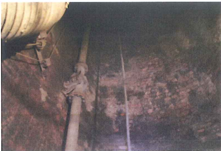
Fot. 6 Rurociągi w szybie
