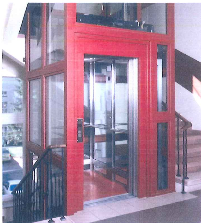
Fot. 2 Przez otwarte drzwi widoczny pionowy panel dyspozycji (prod. SURSUM)
