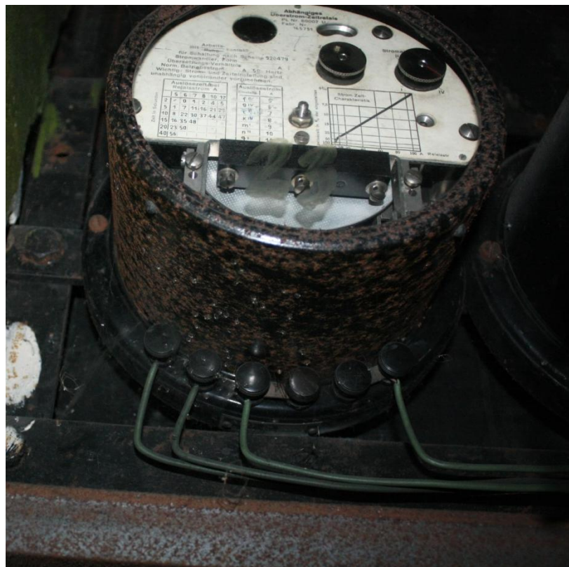
Fot.36 Stan zachowania - przekaźniki nadprądowe zwłoczne
