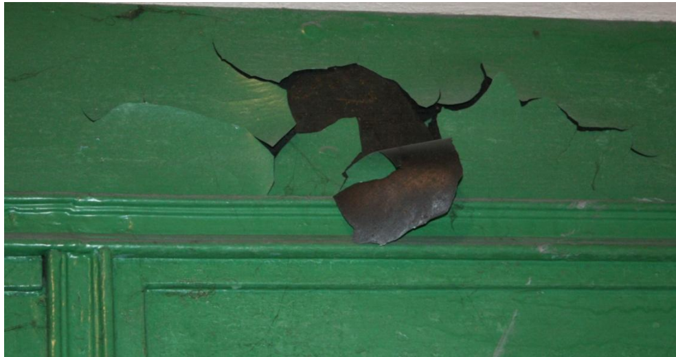
Fot.5 Odwarstwienie przemalowań – widoczne podłoże stalowe bez produktów korozji
