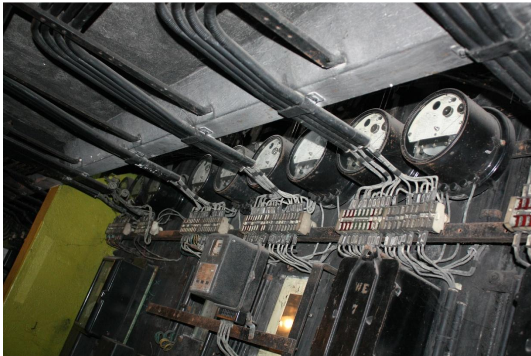
Fot.31 Przekładniki nadprądowe zwłoczne listwy zaciskowe i liczniki
