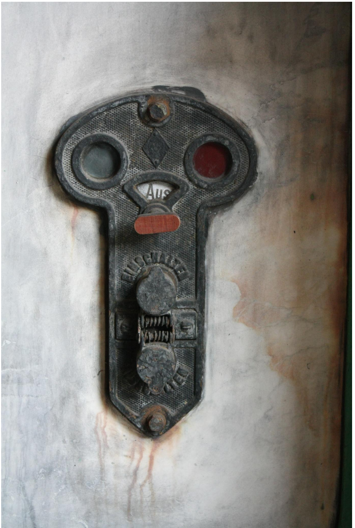
Fot.12 Przełącznik II wzoru z wtórnym pokrętkiem
