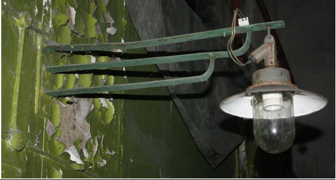
Fot.39 Lampa z wysięgnikiem i puszkami natynkowymi- do zachowania
