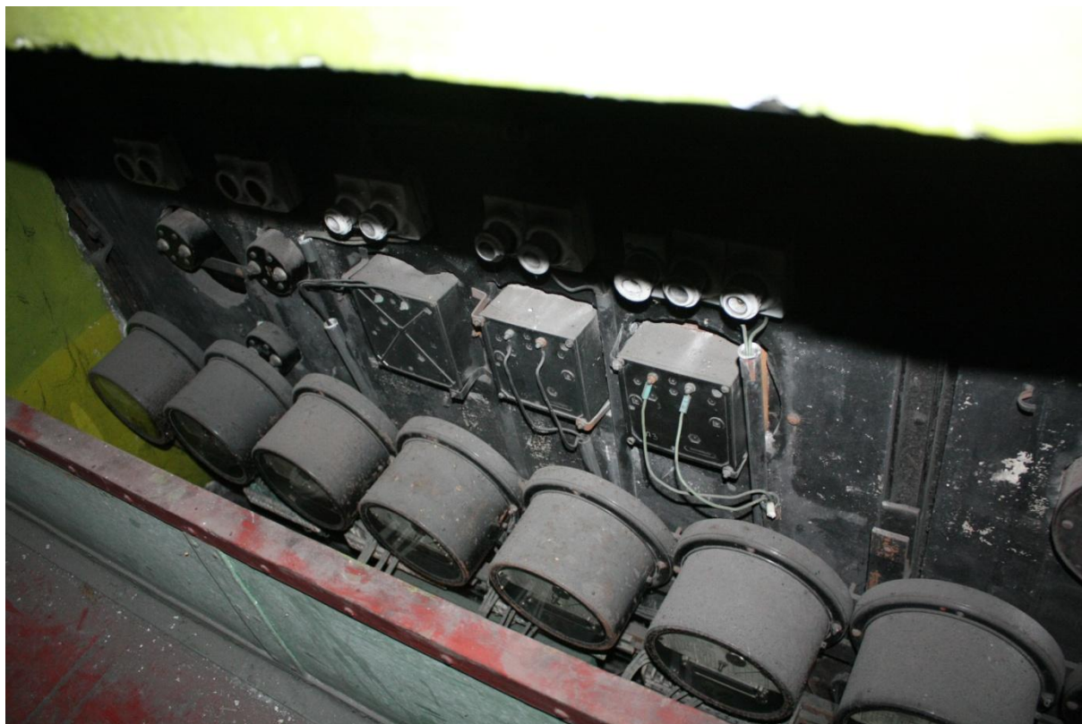
Fot.30 Pole 3 przekaźniki nadprądowe zwłoczne
