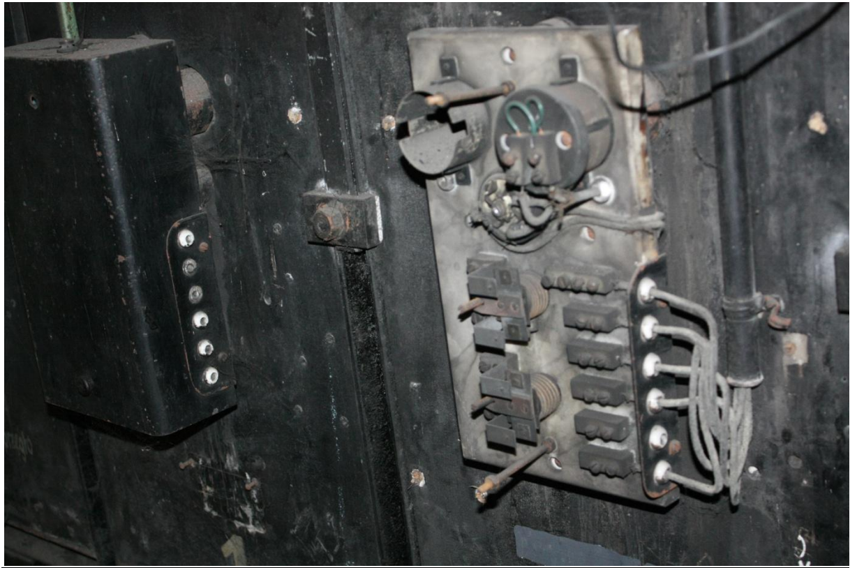
Fot.35 Puszka przełącznika i zestyki z kontrolkami
