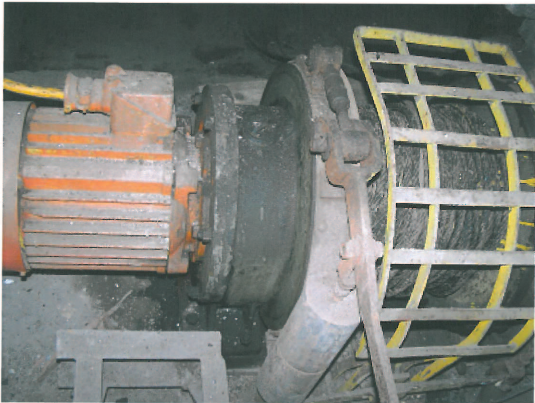
Rys. 3. Silnik i przekładnia
